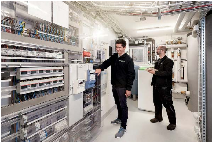
Die zentrale Steuerung.
