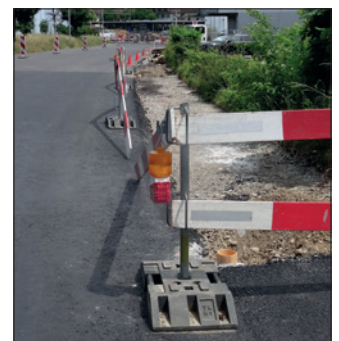
Provisorisch instand gestellt: Der Grubenweg.
